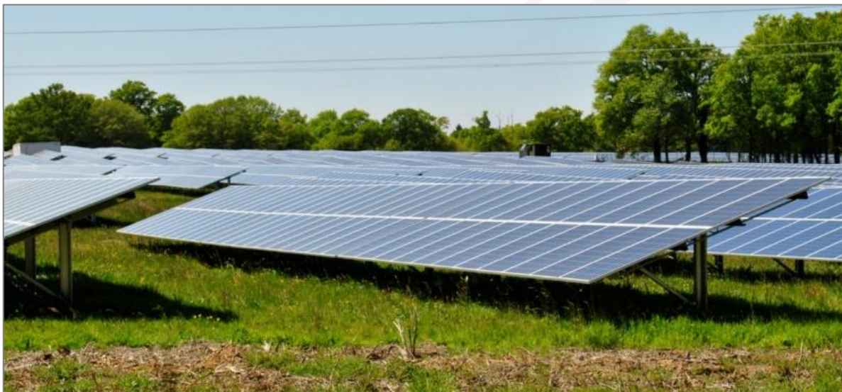
Parc solaire de Grateyrolles (Source : ENCIS Environnement)
